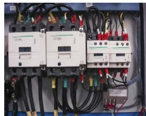
Рис. 6. Концы входного провода электропитания
